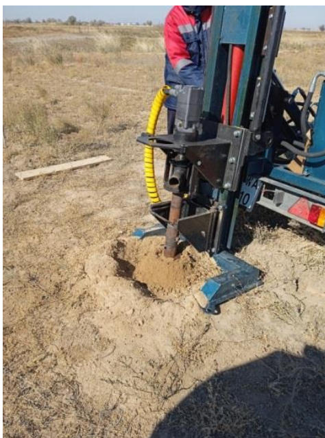
Рисунок 3 - Шурфирование на второй площадке от крайней лунки в сторону на 50 см (экспозиция 24 часа)
